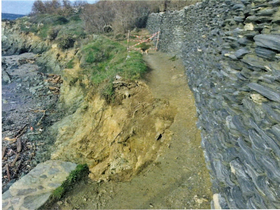
Photo 6 : l'effondrement du sentier des douaniers près de la fontaine
