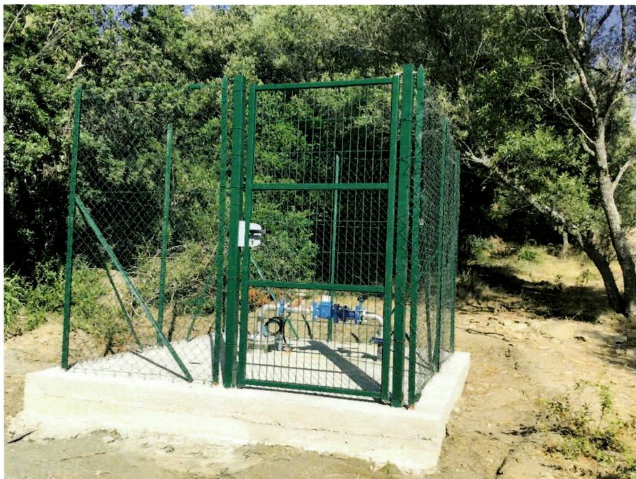
Photo 11 : des forages équipés et protégés
