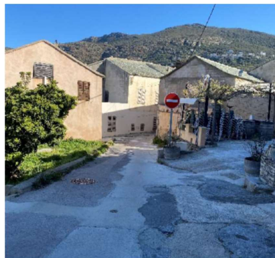
Photo 5 : Chaussée dégradée aux abords du Port
