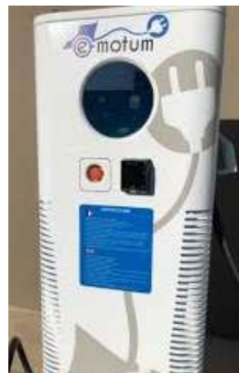
Photo 11 : une borne de recharge pour véhicules électriques
